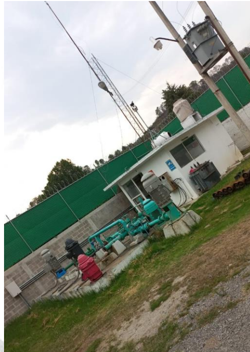
“Pozo de agua potable, San Juan Tlacotempa”
